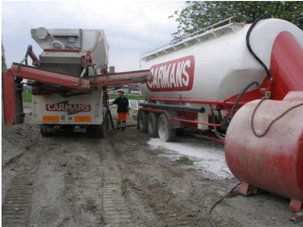
Bindemittelbefüllung (auch per BigBag oder Silo möglich)
